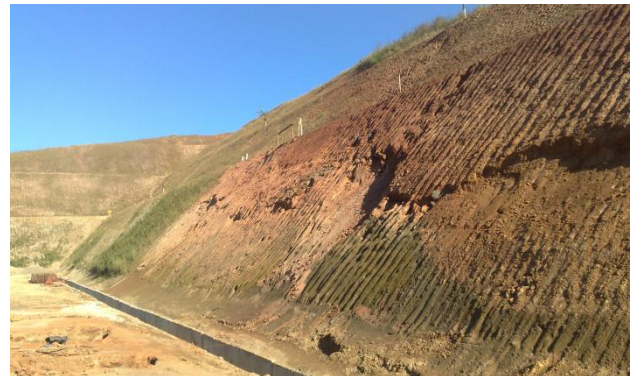
Figura 3. Talude de Corte com Deslocamento de Solo.
