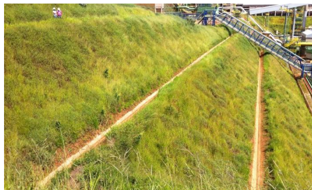
Figura 8. Crescimento da Vegetação nos Taludes.
