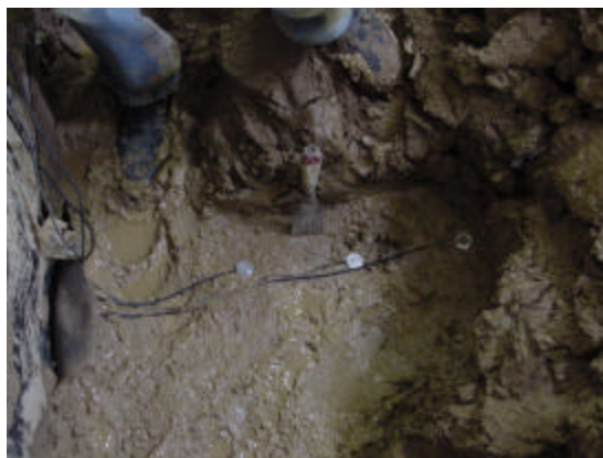
Figura 48 – Remoção dos 40 cm da argila mole e instalação das células de tensão total
